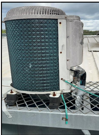
FIG. 12 – MASSA METÁLICA EQUIPOTENCIALIZADA
