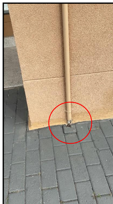
FIG. 9 - INTERLIGAÇÃO EXPOSTA, NÃO CONFORME – ALUMÍNIO EM CONTATO DIRETO COM ALVENARIA.
