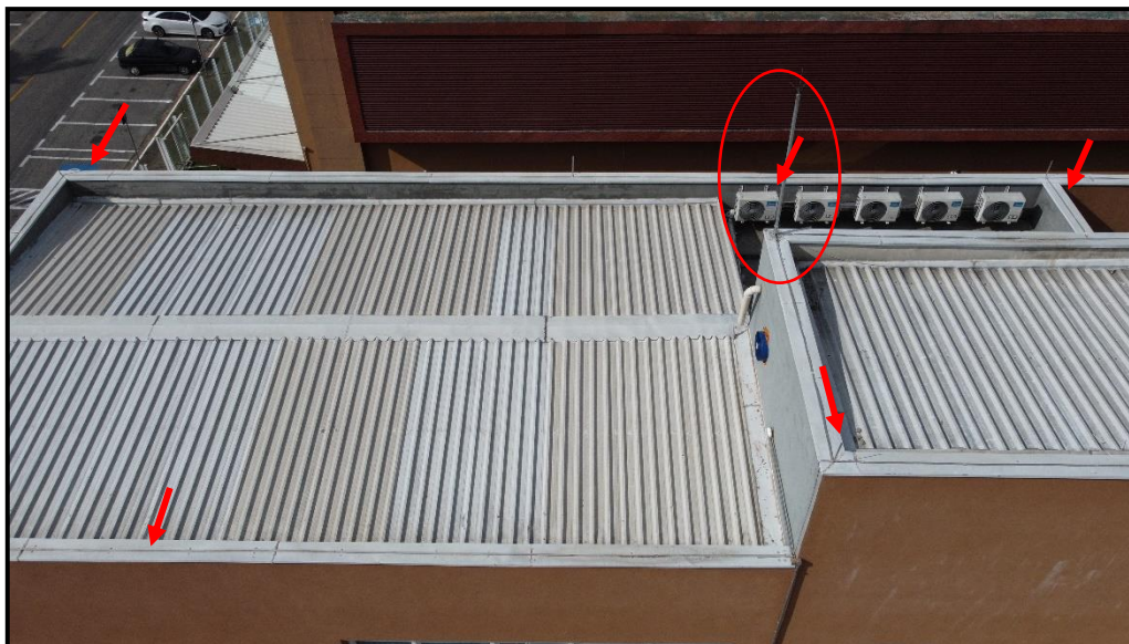
FIG. 25 – COMPONENTES DE CAPTAÇÃO – CAPTOR FRANKLIN, FITA DE ALUMÍNIO E MINICAPTORES
