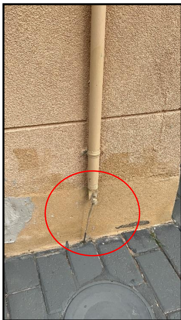
FIG. 8 – INTERLIGAÇÃO EXPOSTA, NÃO CONFORME
