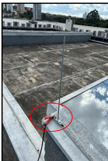
FIG. 5 – CAPTAÇÃO – FALTA DE CONEXÃO
