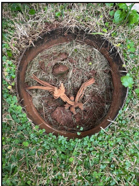
FIG. 10 – CAIXA DE INSPEÇÃO DE ATERRAMENTO OBSTRUÍDA SUJEIRA TERRA.
