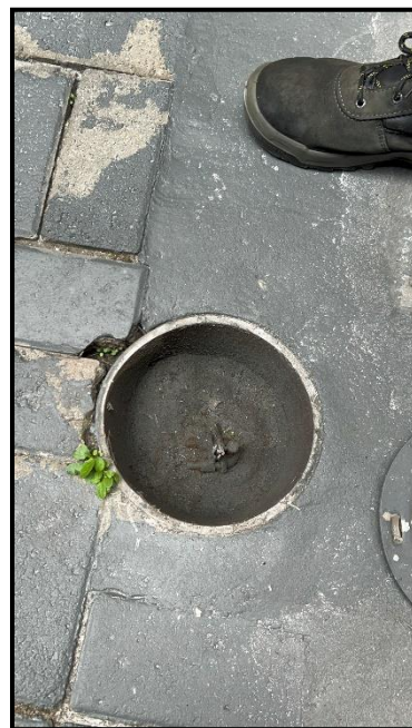
FIG. 11 – CAIXA DE INSPEÇÃO DE ATERRAMENTO OBSTRUÍDA SUJEIRA TERRA.
